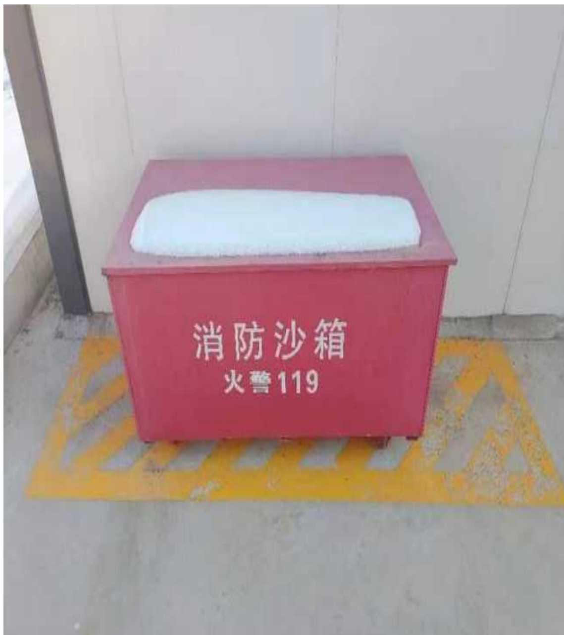
附图 5 危废间消防沙箱
