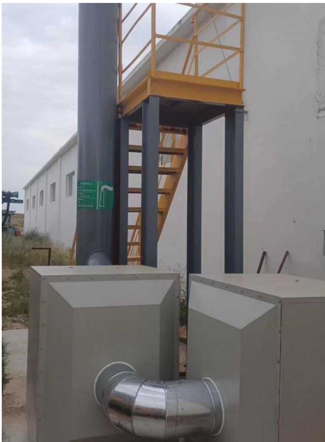
附图 5 危废暂存间排气筒
