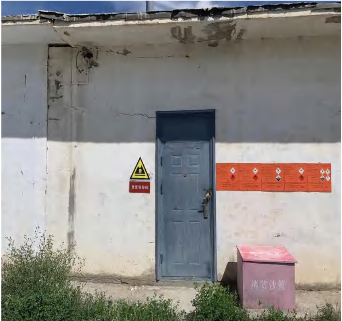
附图 6 危废间消防沙箱
